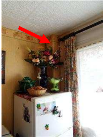
032 - Appartements - Cuisine LOT 0102 PH18 : amiante ciment
