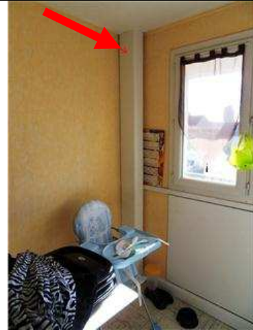
055 - Appartements - Cuisine LOT 0202 PH19 : amiante ciment
